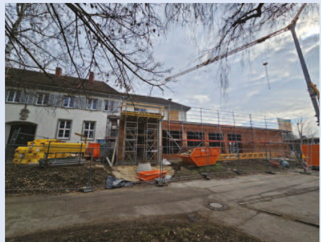
Auf der östlichen Seite des Schulhauses wird der Anbau realisiert. Hier wird mehr Platz für Schulkinder geschaffen.
