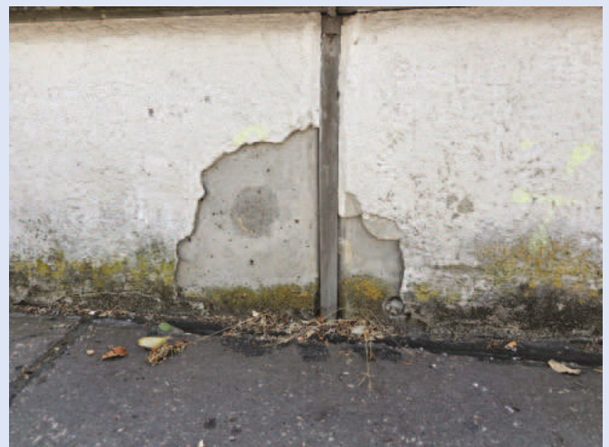
An mehreren Stellen ist die Oberfläche der Brücke beschädigt, sodass Wasser und Salze in das Mauerwerk eindringen können.
