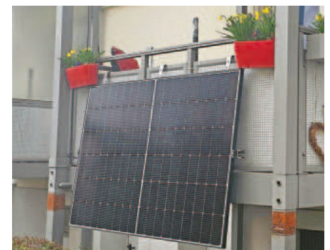
Solarmodule können beispielsweise an Balkonen angebracht werden.
